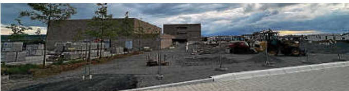
Auf Hochtouren laufen die Arbeiten rund um die Grundschule und am Quartiersplatz im Limespark
