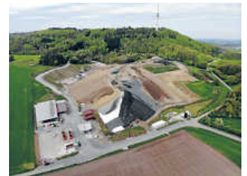
Das Deponiegelände Stäffesrain. Hier findet am 6. Juni 2023 bereits der 10. Baustellenstammtisch der Abfallwirtschaft Hohenlohekreis statt
