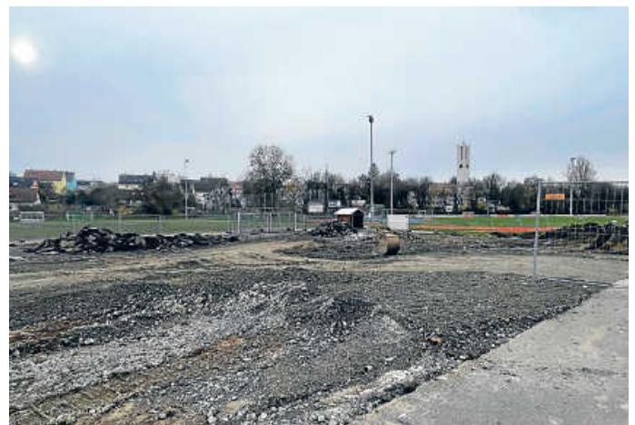
Vorbereitende Maßnahmen zum Feuerwehr-Neubau und für den neuen Tartan-Bolzplatz auf dem TSG Gelände Foto: Stadt Öhringen
