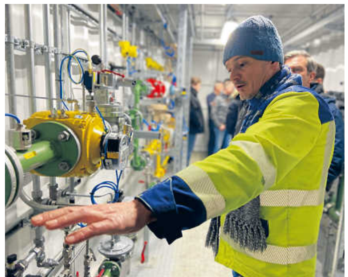
Peter Meier von der Netze BW führte die Teilnehmerinnen und Teilnehmer des 10. Hohenloher Energieabends durch die „Wasserstoff-Insel Öhringen“ und erläuterte den Aufbau des Pilotprojektes
